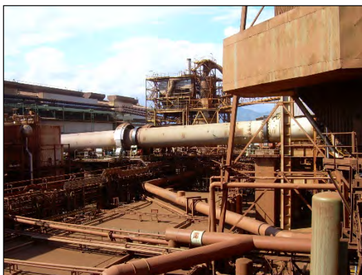
Metten koppel aandrijving roterende oven
